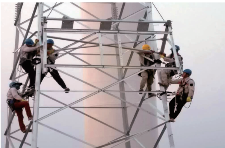
8月15日,尚风沂北风电场集电线路正式开工,该工程是供电公司继灌云风电工程一期、二期工程成功并网发电后的又一重点工程,创造了该公司历年来单项目合同、单项目线路架设、工程量“三项之最”。(电宣)
